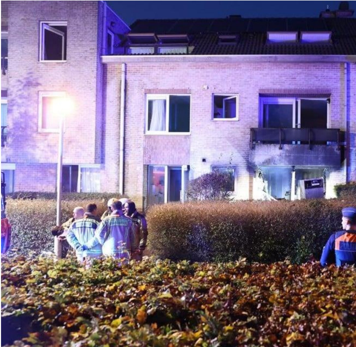
De schade op het gelijkvloers is heel groot. De andere flats hebben rookschade. — © bfm
